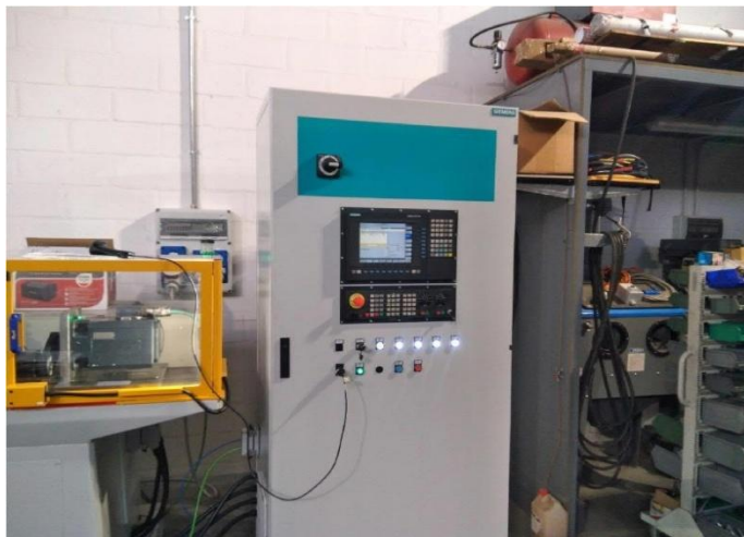
Figura 8: Quadro elettrico di controllo
